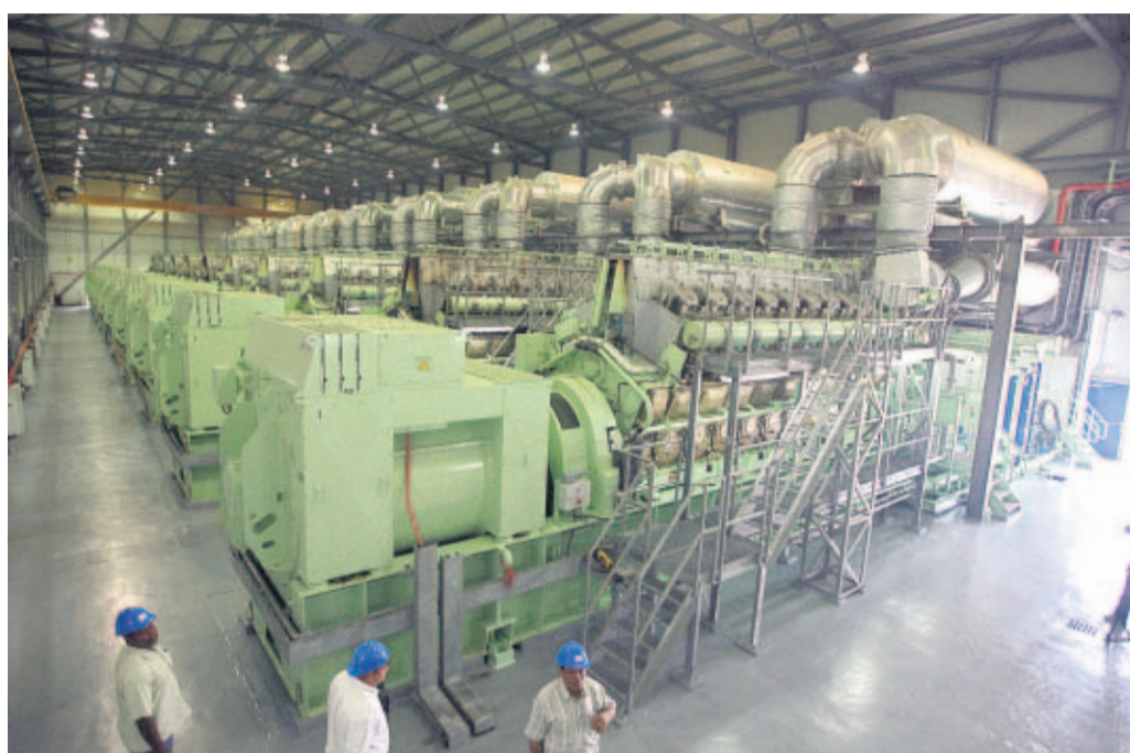
CAPACIDAD INSTALADA. Este año se incorporó al sistema la planta termoeléctrica de Cativá, con 87 megavatios de capacidad.
