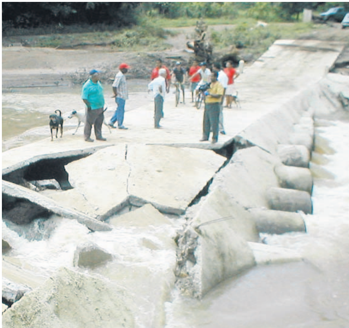
DAÑO. Las lluvias socavaron parte de la base y ocasionaron rajaduras en la losa de la estructura.
