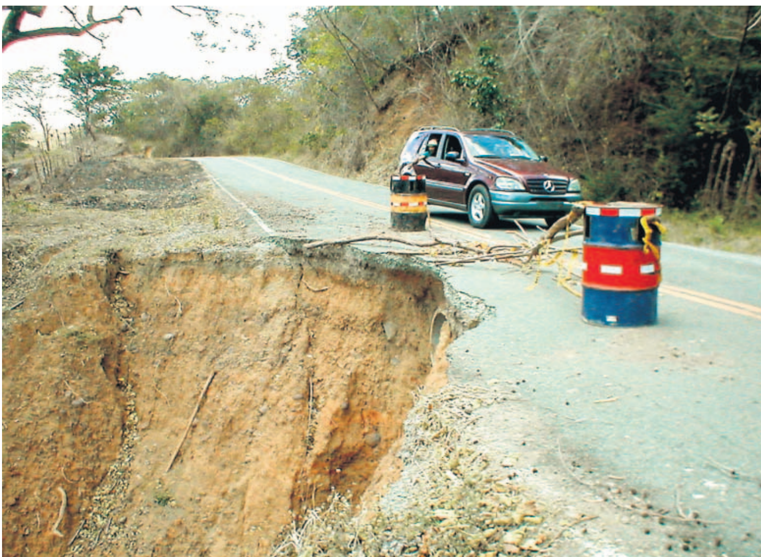
PELIGRO. Deslizamiento de tierra a la altura de comunidad de La Sabaneta.
