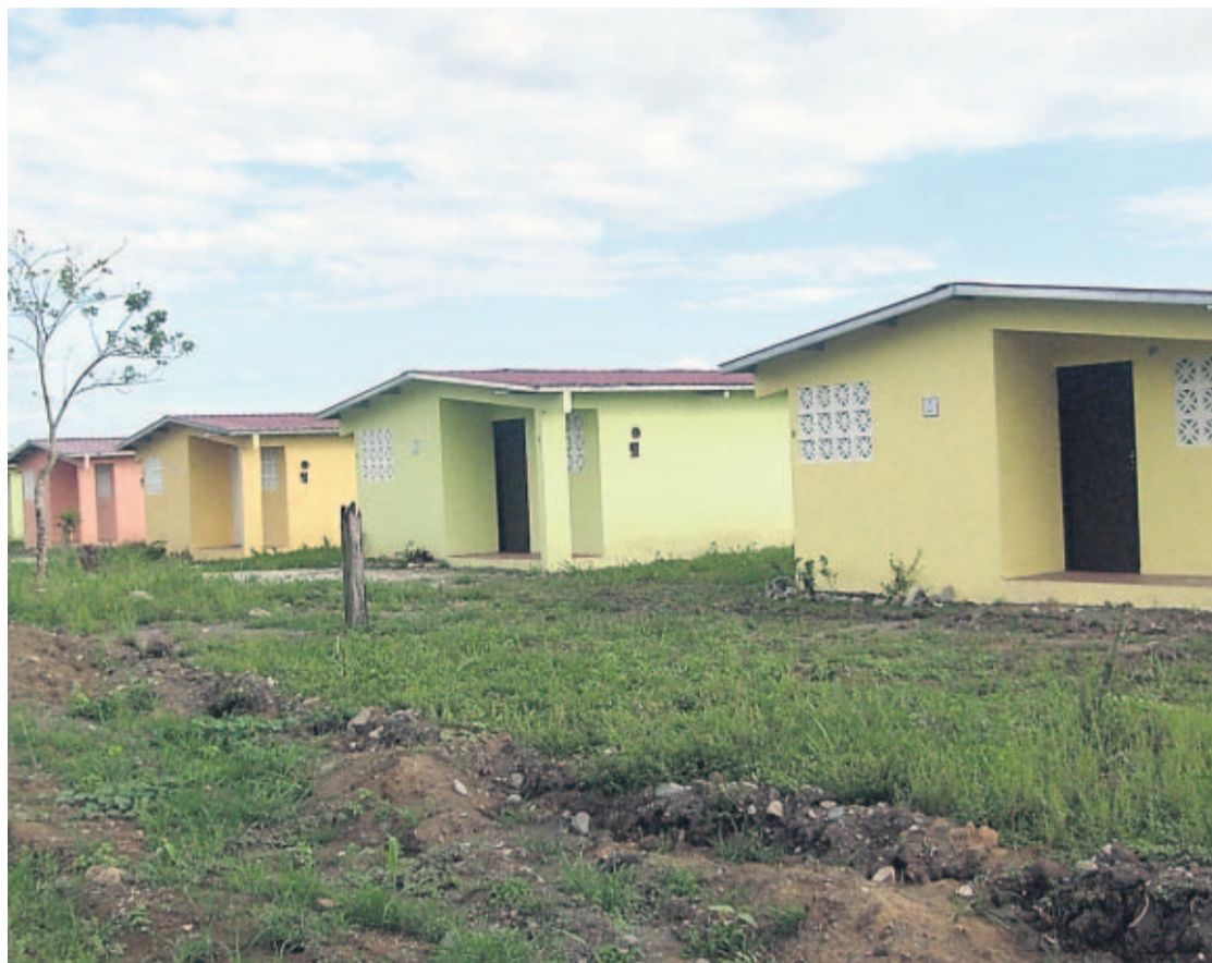
DAÑOS. Siete de las casas han sido vandalizadas por desconocidos.
