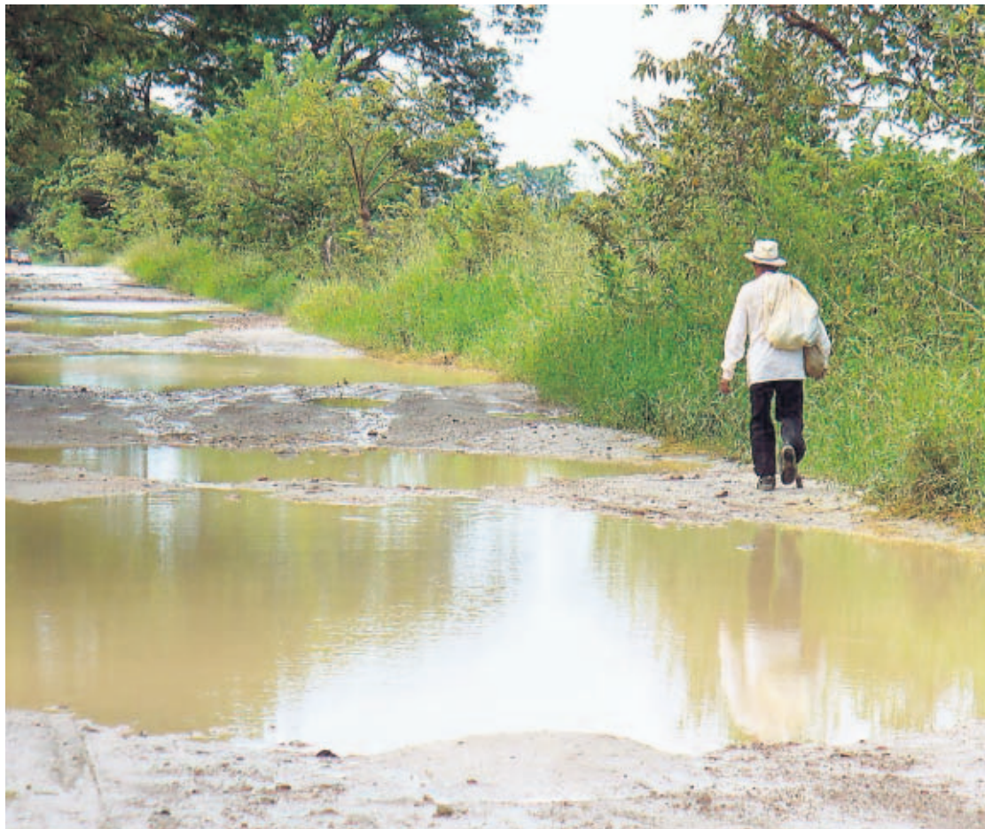
DETERIORO. Calle de la comunidad de Santa Clara.
