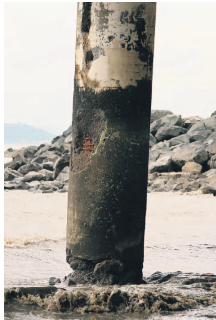
CORROSIÓN. Los golpes constantes de la marea y el agua salada tienen carcomida la base de esta columna del Corredor Sur.
