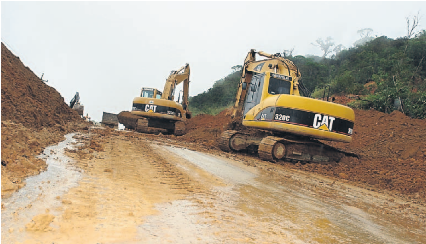
DESGLIZAMIENTO. La carretera se limpió ayer por la mañana.
