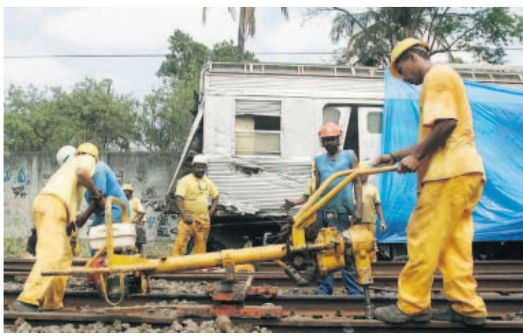
DAÑO. Una cuadrilla de obreros trabaja para reparar los graves daños tras el choque de trenes en Río de Janeiro. REUTERS/Bruno Domingos.
