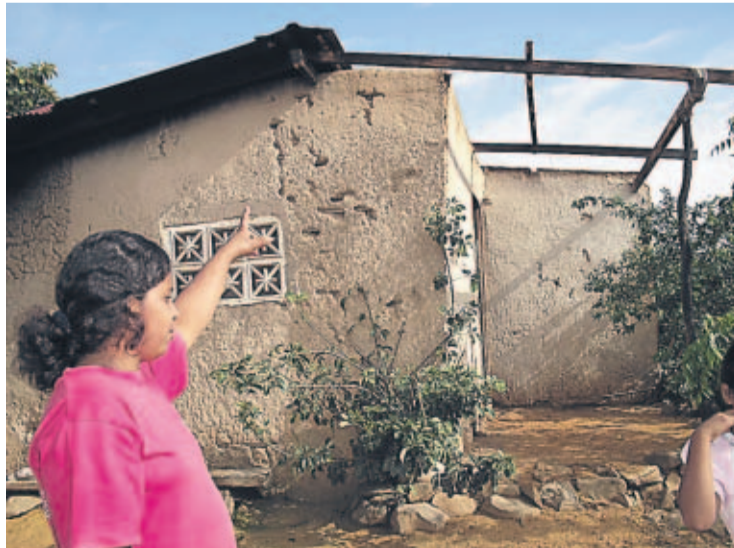
DAÑOS. Zelideth Ramos muestra cómo quedó su residencia.
