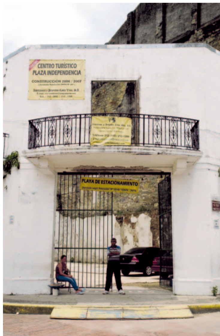
DETERIORO. La antigua Librería Preciado es un cascarón, cuyo propietario utilizaba como estacionamiento. LA PRENSA/Victor Arosemena
