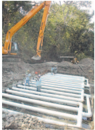
Galería de filtración
