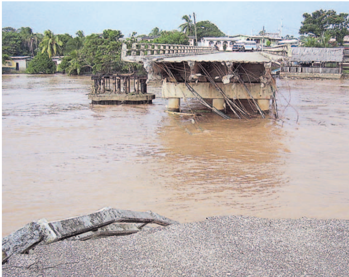
DESTROZOS. El puente sobre el río Indio en la costa abajo de Colón fue destruido por la furia del río.
