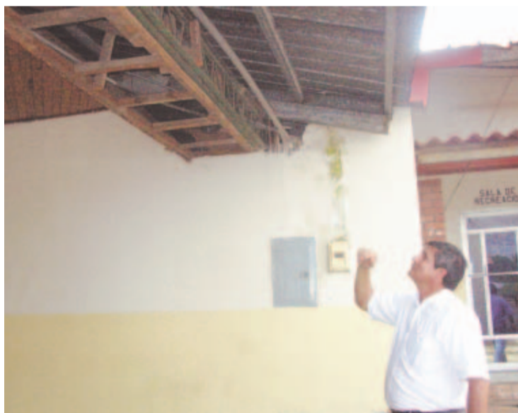
ESCAPE. Los reos se las ingenieron para fugarse por el techo.
