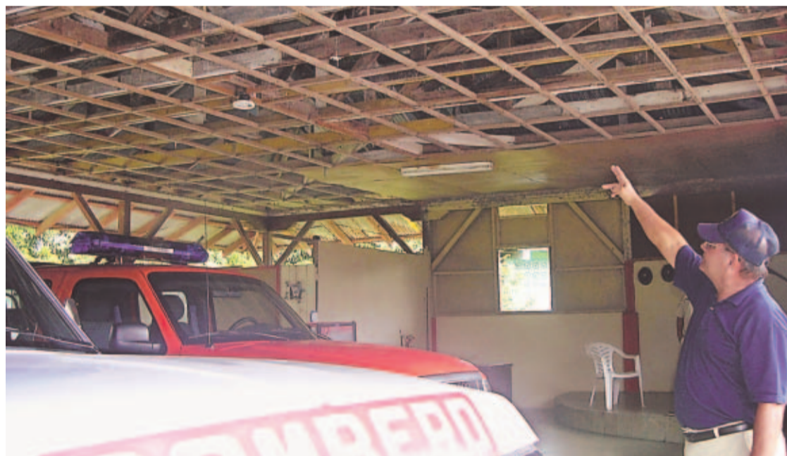
ESTRUCTURAS. El techo de la estación de Antón está en pésimas condiciones.
