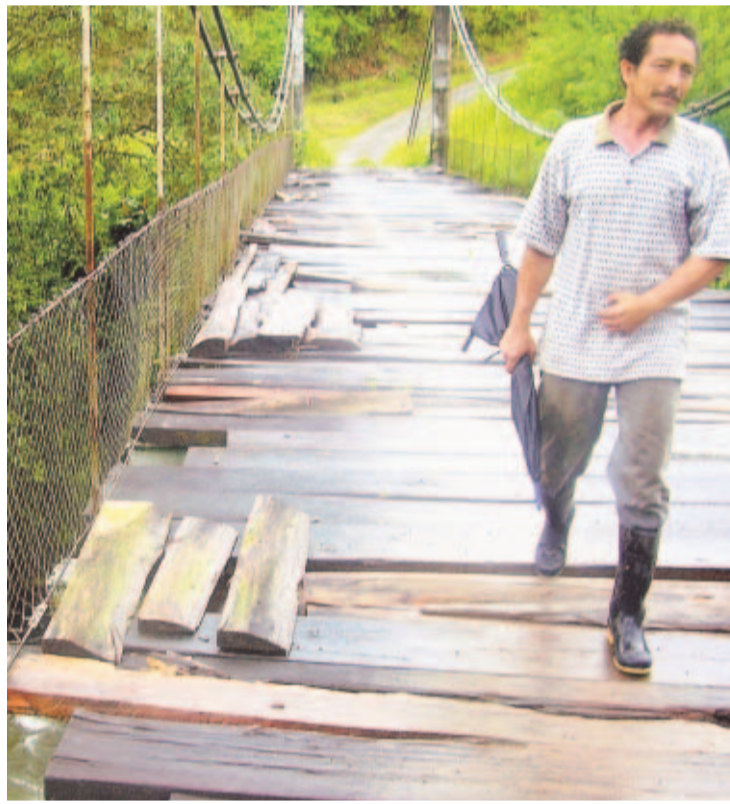
PELIGRO. Este precario puente no es seguro para los transeúntes.
