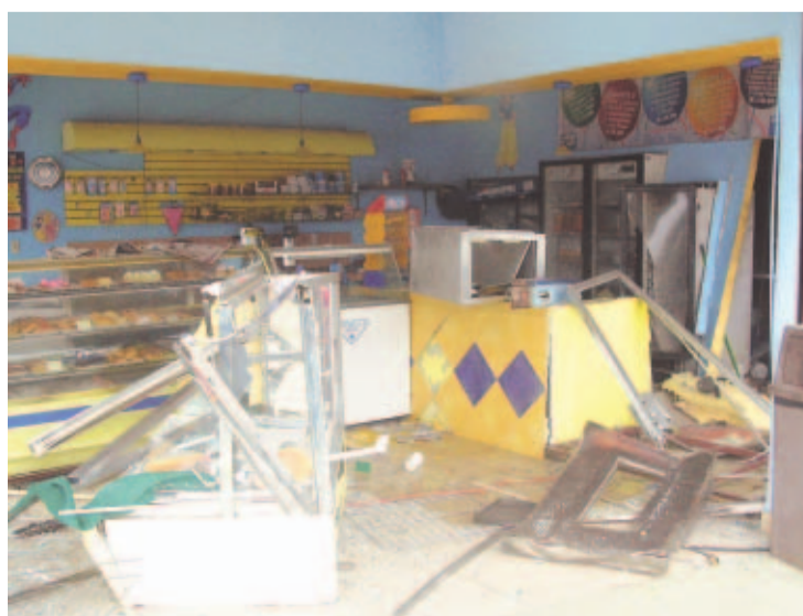
ESCENARIO. La explosión destruyó parte del mobiliario de la panadería.
