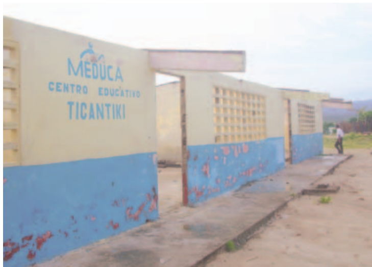
INTEMPERIE. La escuela sin techo se ve desolada.
