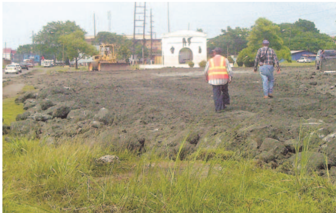
AVANCE. La empresa contratista Representaciones Don Chico, S.A. trabaja en el relleno del área de construcción.
