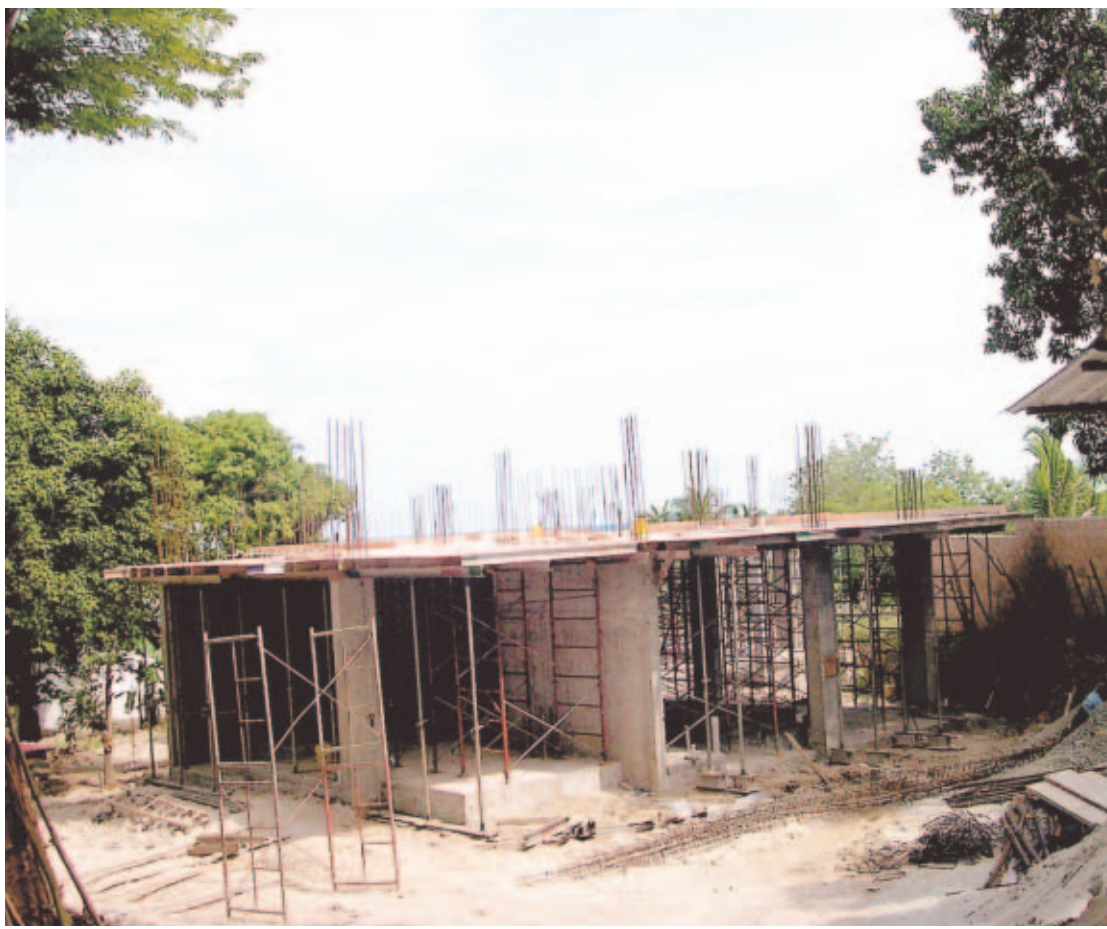
ESTRUCTURA. No hubo mérito para detener los trabajos, de acuerdo con las autoridades técnicas en la materia.
