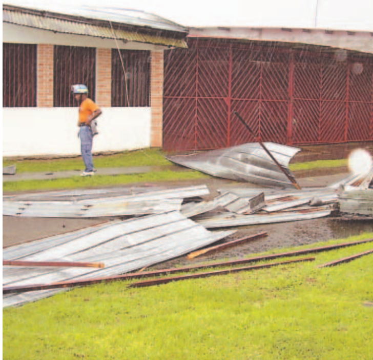
DAÑOS. Aunque el fenómeno natural no dejó víctimas, sí provocó pánico entre los residentes de las viviendas afectadas.
