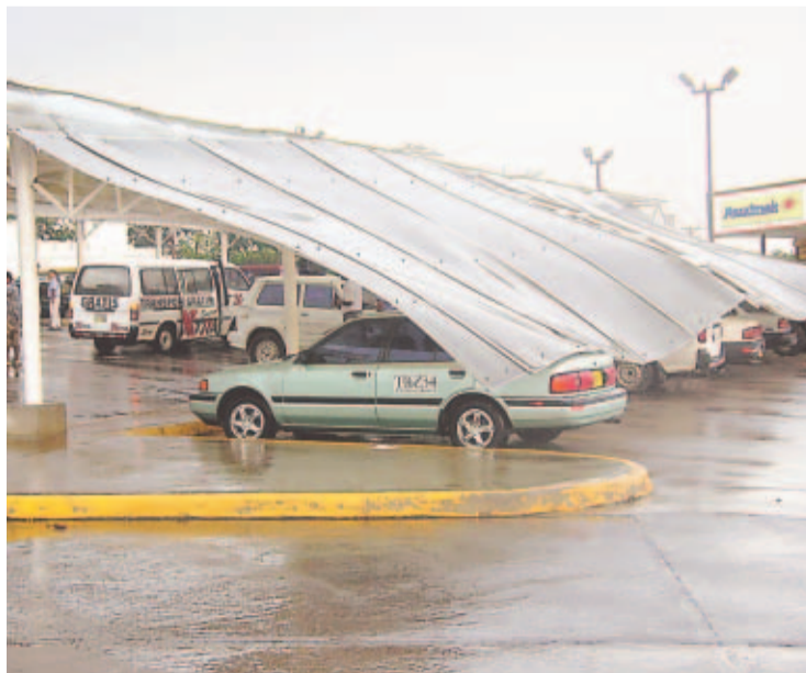
INCIDENTE. Las planchas de cinc no resistieron la fuerza del viento que sopló en Arraján.
